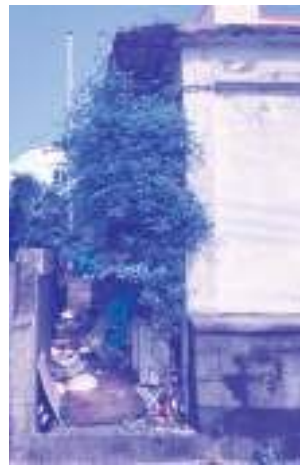
ごみ放置と屋根落下の危険性
