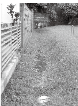
大雨の時水が溜まった排水溝（6月26日屋良第2児童公園）
