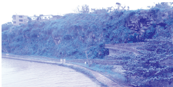
急傾斜の崩落と冠水対策を早急に
